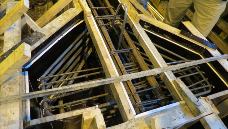
Kuva 1. Esimerkki konsolin raudoituksesta muotissa. Valusuunta on konsolin sivusuunnassa. (A. Saariaho, henkilökohtainen tiedonanto, 3.12.2024)
