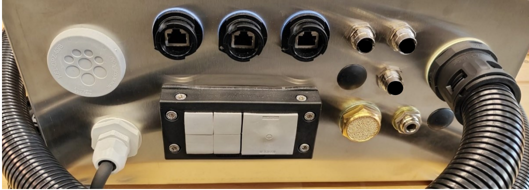
Kuva 6: Läpiviennit liittimiseen ja suojaukseen
