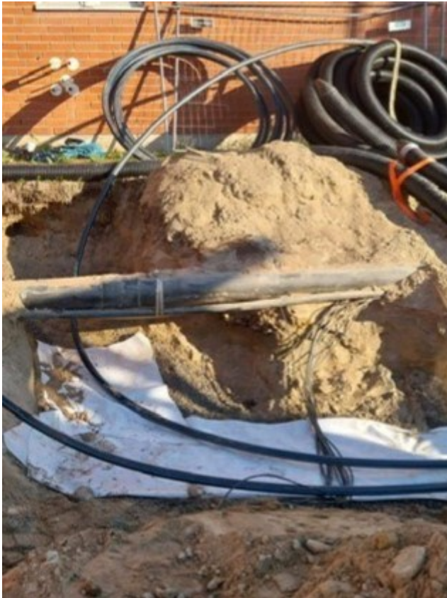
KUVA 3. Vanha kanaaliputki ja PEM-käyttövesiputki
