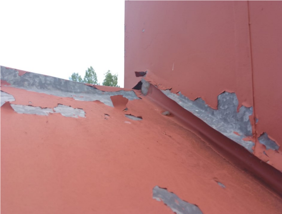
Kuva 20. Savupiipun pellityksen tiiveysvaurio.
