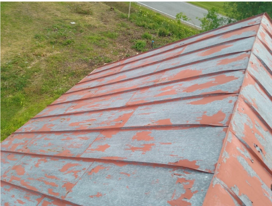
Kuva 19. Vesikaton pinnoite halkeillut.
