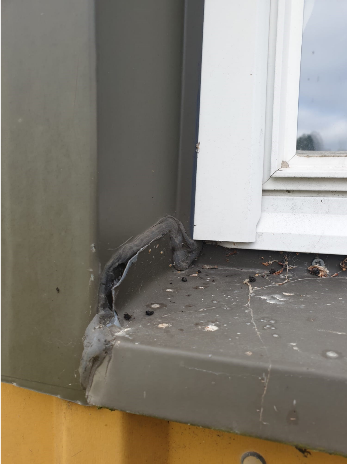
Kuva 14. Vuorilaudan ja vesipellin liitos ensimmäisen kerroksen ikkunassa.
