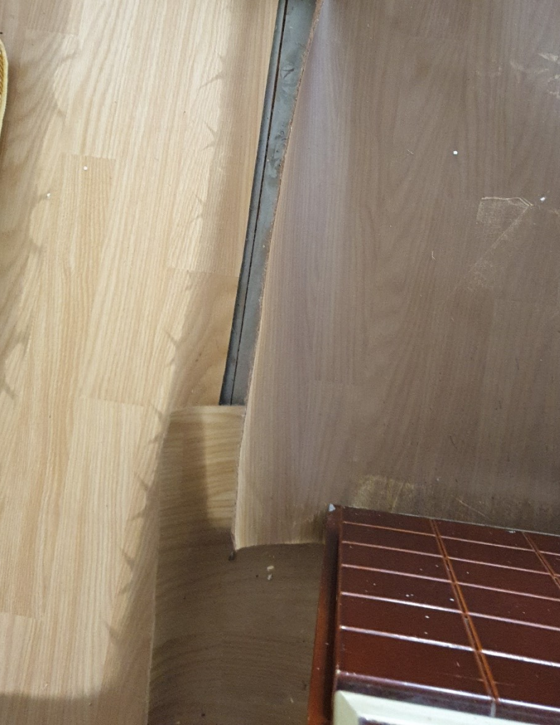
Kuva 17. Toisessa kerroksessa muovimatto irronnut.
