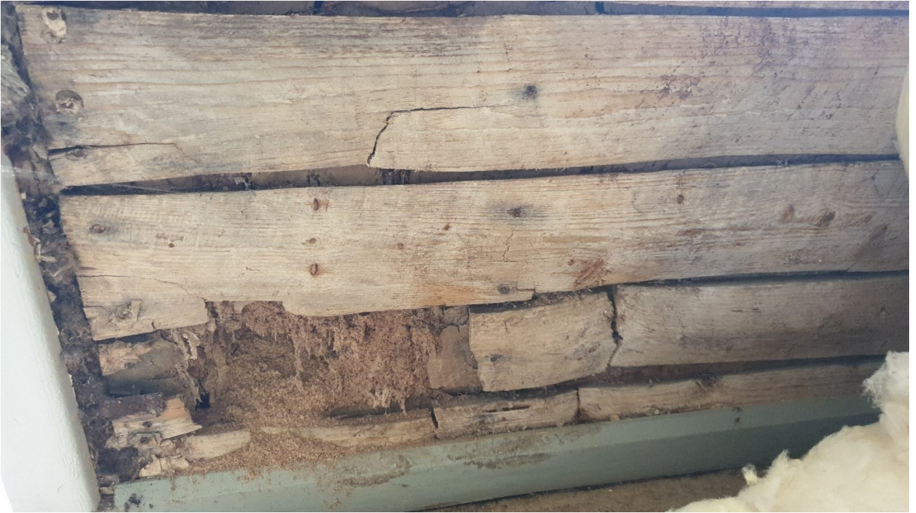
Kuva 12. Merkkejä vanhoista kosteusvarioista.
