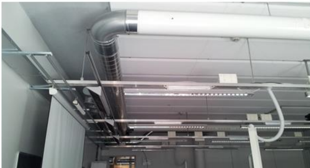
Kuva d) Luokka B244 muutostöiden jälkeen. IBIS-tuloilman päätelaitteiden sijoittelu katonrajassa.
