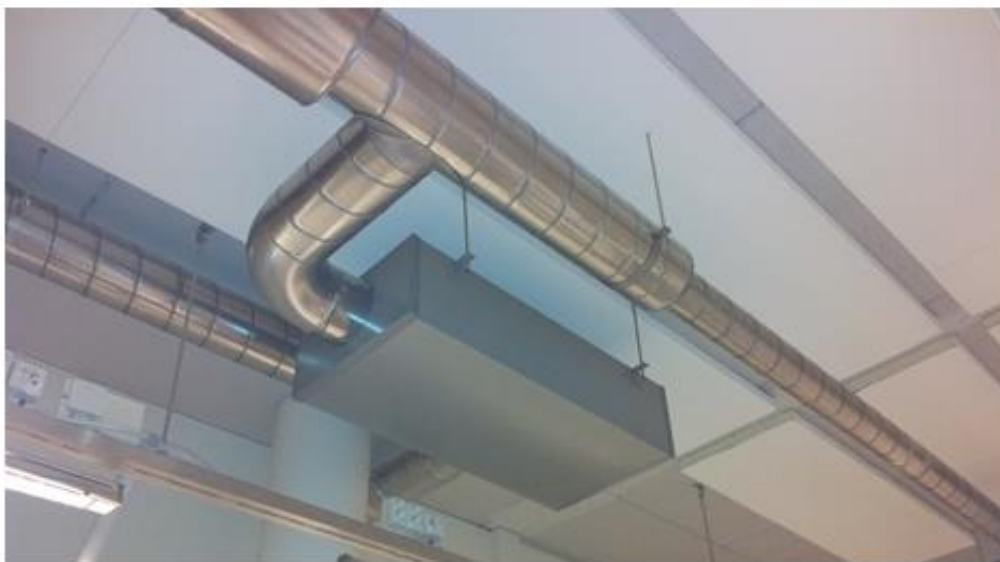
Kuva b) Luokka B244:n tuloilmalaatikko, joka ei näkynyt piirustuksissa.
