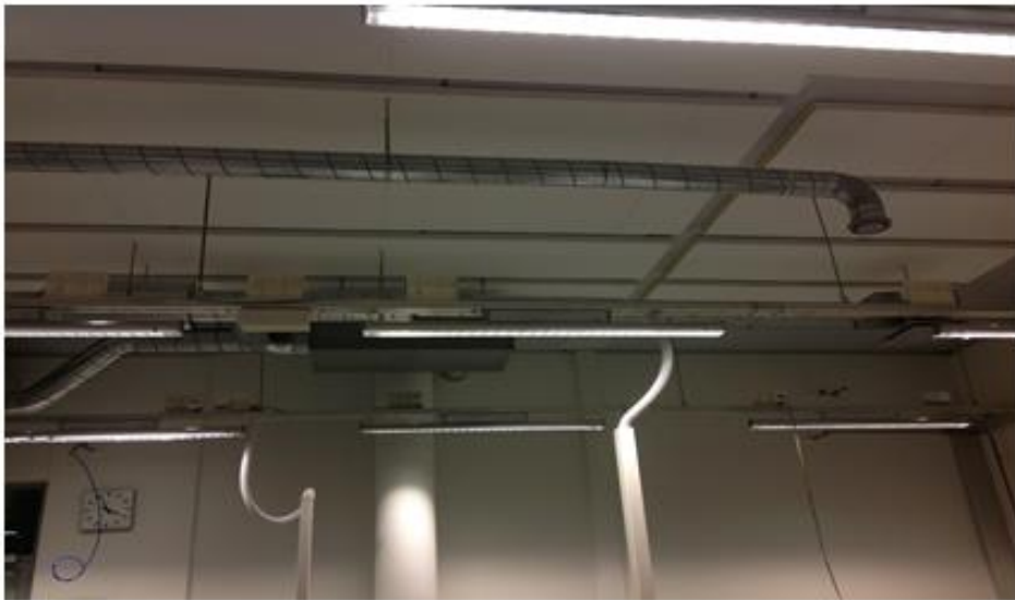
Kuva 14. Pilottiluokka B244, lähtötilanne. Vasemmalla alhaalla näkyy käytöstä poistettu hätäsuihku. Kuvassa myös piirustuksista puuttuva tuloilmalaatikko ja poistoilmaventtiili.
