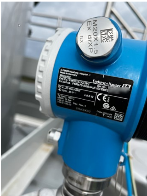
Kuvio 2. FMR67B 80Ghz Mikroaaltotutka säiliön päällä asennettuna pintamittaukseen varten
