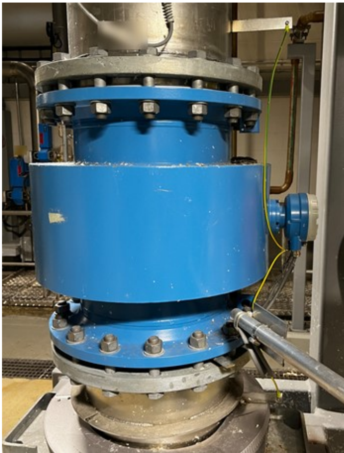
Kuvio 1. Sähkömagneettinen virtausmittaus asennettuna mittaamaan nesteen virtausta
