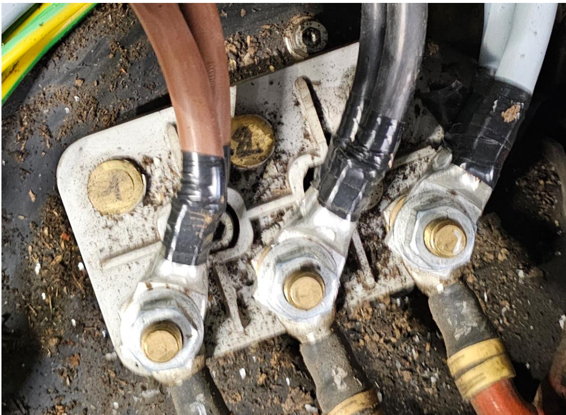
Kuva 4. Mustan johtimen alempi kaapelikenkä osuu moottorin kytkentäpisteen kiinnitys ruuviin
