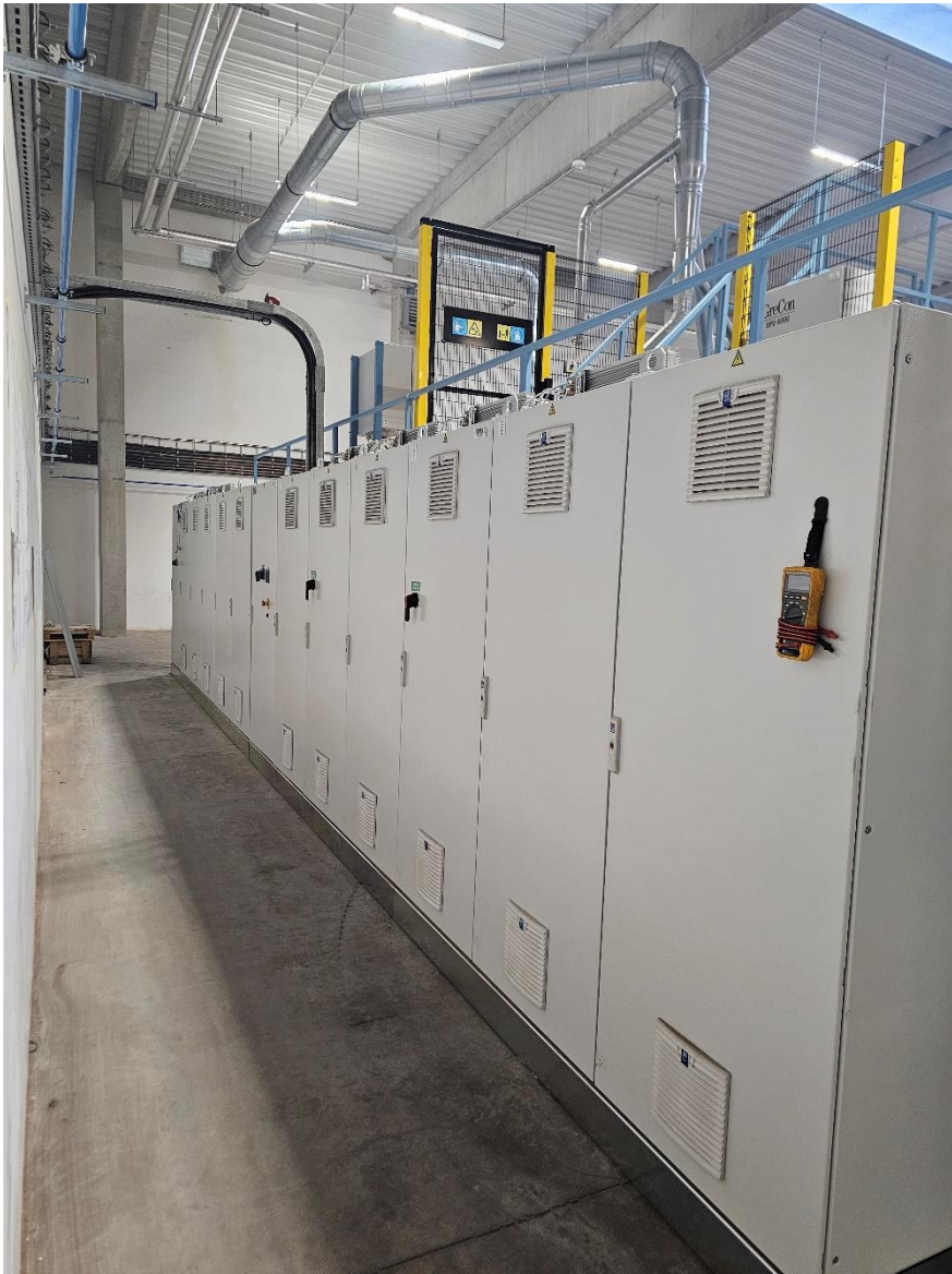
Kuva 6. Kuvassa paneelisahalinjan MLCC1 ja MCC2 pääkeskukset
