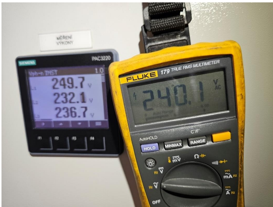
Kuva 19 Yleismittarilla todettu jännite-ero L3 vaiheessa
