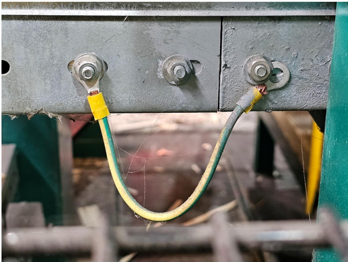
Kuva 1. Kaapelihyllyjen maadoitus kiinnitetty väärin
