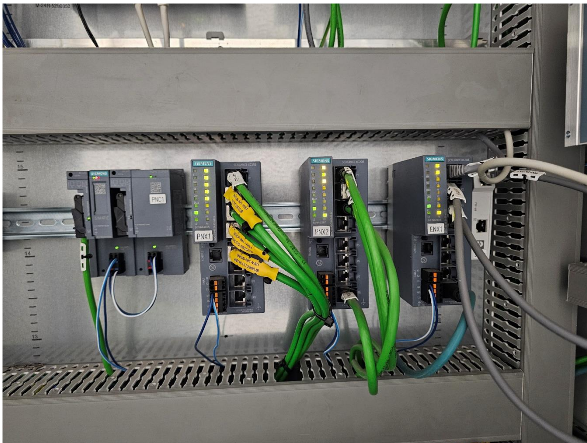
Kuva 7. Kuvassa profinet- ja ethernet- kytkimiä.
