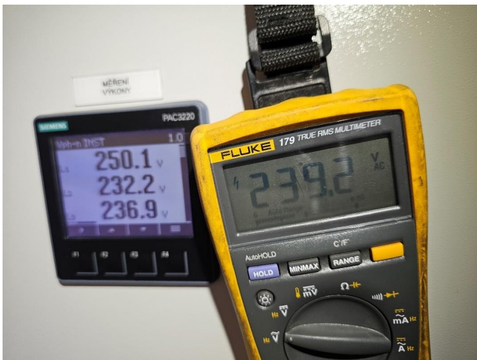
Kuvassa 18 Yleismittarilla todettu jännite-ero L2 vaiheessa
