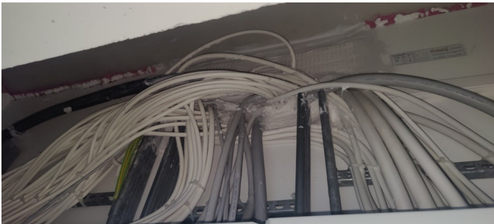
Kuva 18 Paloaseman puoleisen sähkökaapin palokatkot kaapelien läpivienteihin
