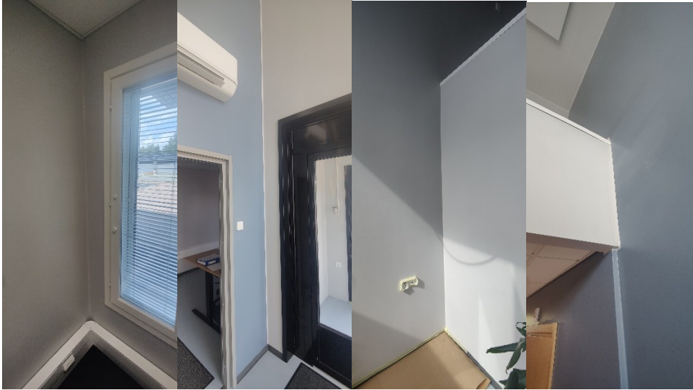
Kuva 24 Uudelleen tiivistetyt ja maalatut nurkat
