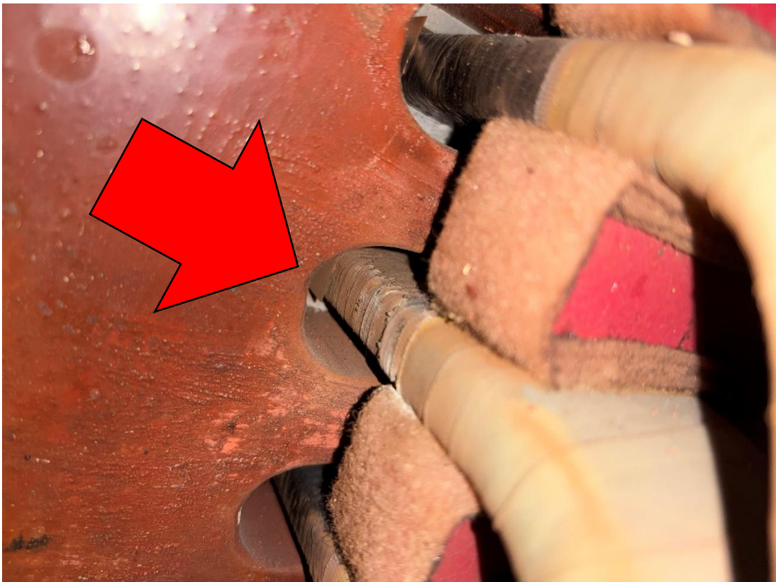
KUVA 23. Vaurioitunut grafiittielektrodi pohjasauvassa
