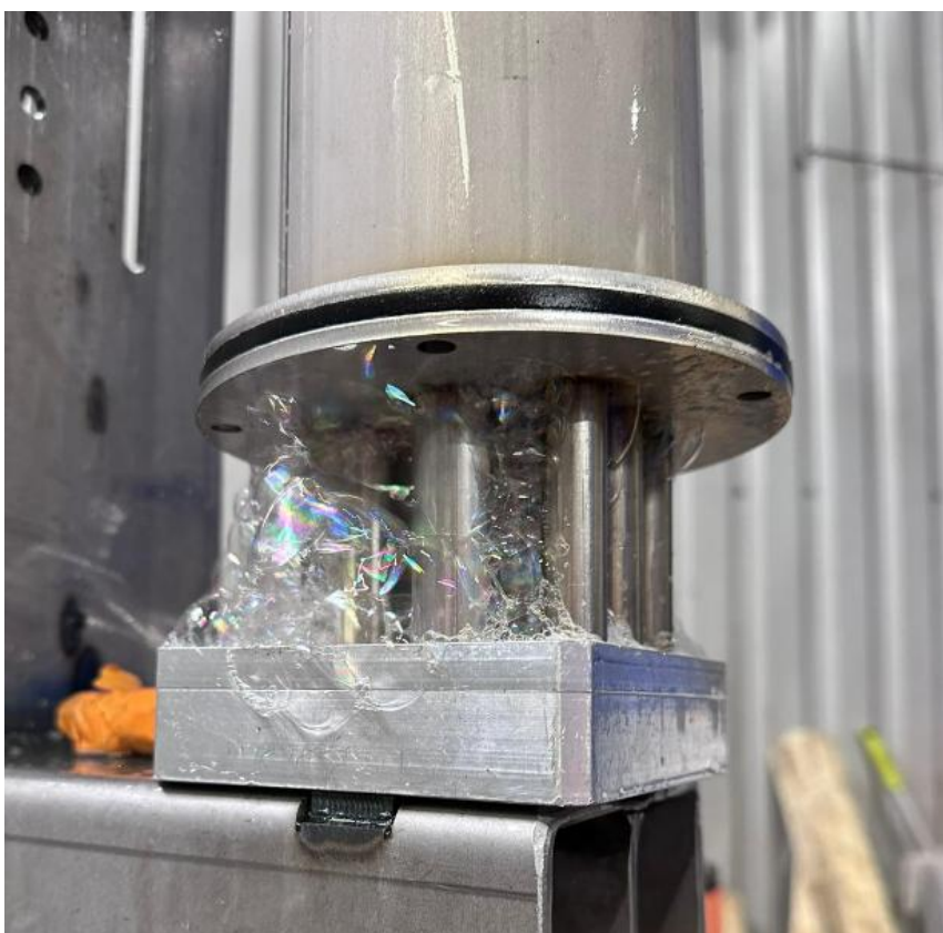
Kuva 10. Laipan ja läpivienti putkien tiivistys epäonnistunut.
