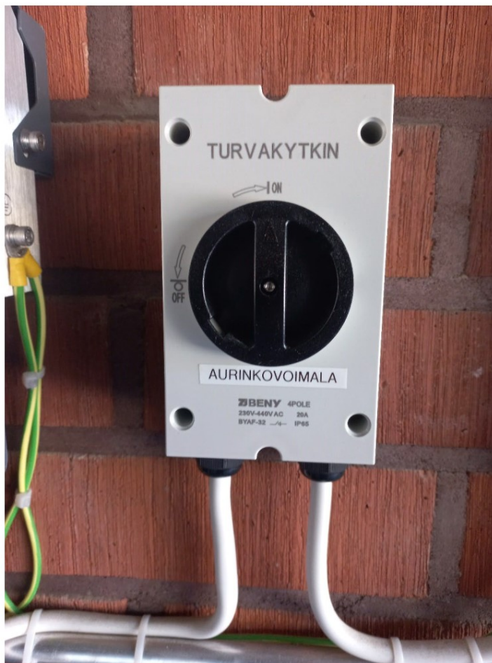
Kuva 6. Vaihtosähköpuolen (AC) erotuskytkin.
