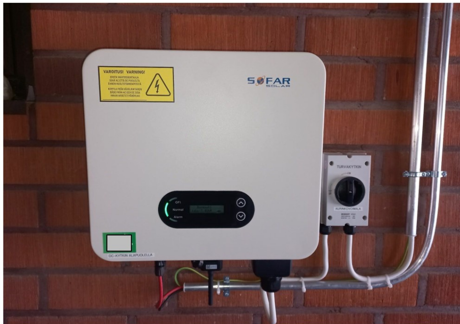
Kuva 2. Invertterissä tarrat paikallaan.
