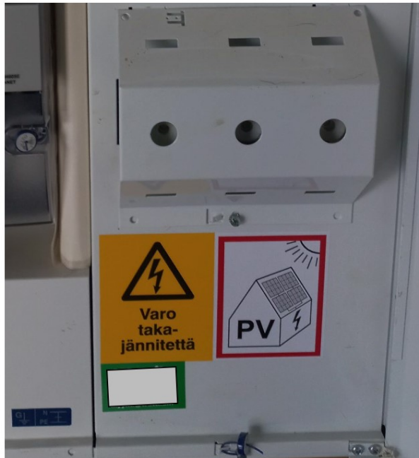
Kuva 1. Takasyöttövaara tarra löytyy pääkeskuksesta. Erotuskytkimensijainti-tarra puuttuu.
