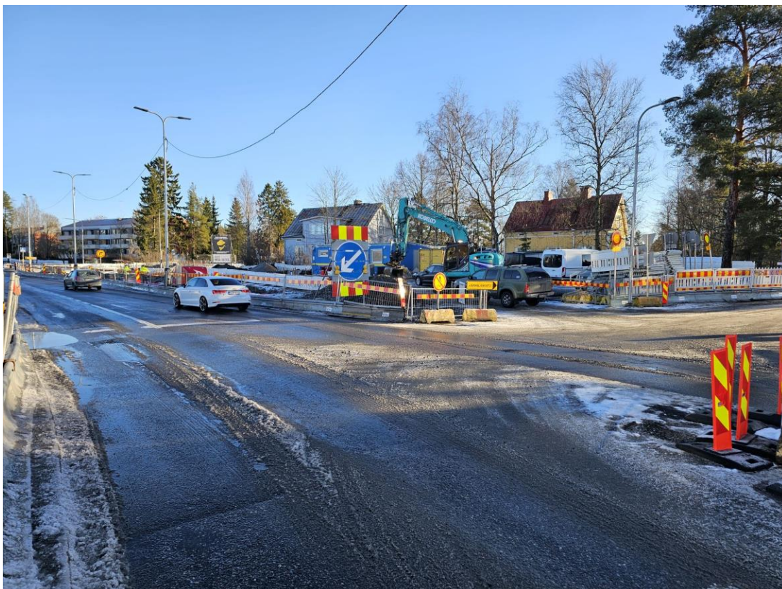
Kuva 6. Tampereen raitiotien radan rakennustyömaa Härmälässä. Työmaa on rajattu liikenteeltä kaiteilla ja varoitusmerkeillä. Kuvassa näkyy myös työmaakalustoa sekä muuttuneita liikennejärjestelyjä. Talvinen sääolosuhde tuo lisähaasteita työmaan turvallisuudelle. (Oma kuva 2025)
