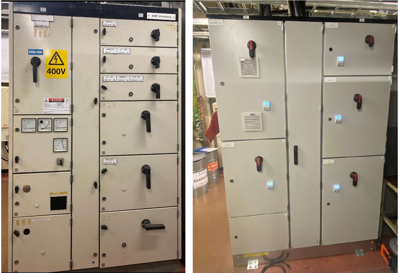
KUVA 2. Vasemmalla on spraykuivaimen vanha purettava sähkökeskus. Kuvassa oikealla on uusi paikalleen asennettu sähkökeskus.
