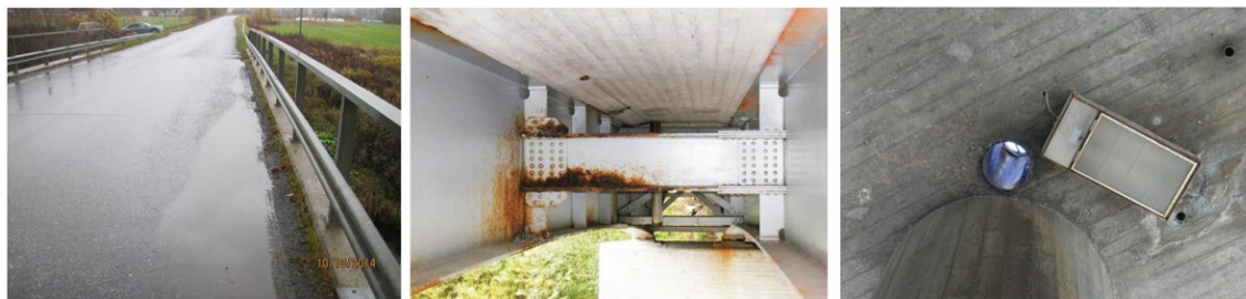
Kuva 16. Vasemmalla: kannen hulevesiputki puuttuu. Keskellä: tippuputkesta valunut vesi on vaurioittanut teräspalkin pintakäsittelyn. Oikealla: liian lyhyt tippuputki ja jatkamatta jäänyt syöksytorvi.
