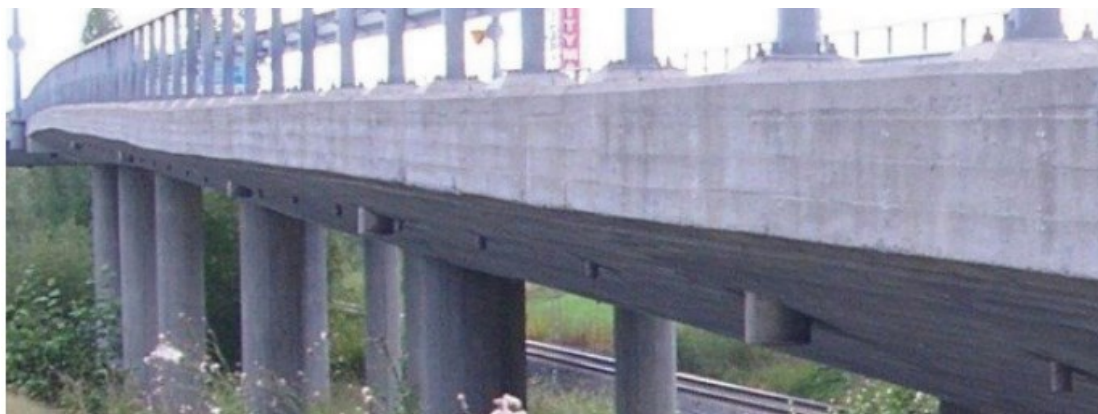
Kuva 15. Hulevesi- ja tippuputkilinja sillan pituussuunnassa.
