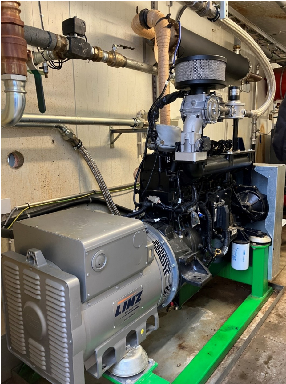
Kuva 1. Sähköntuotantoon käytettävä laitteisto.
