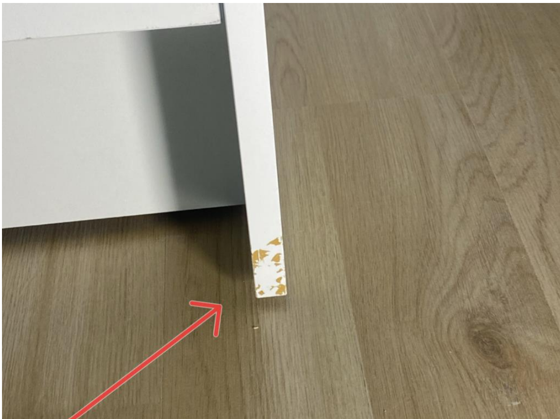
Kuva 8 Kalustelevyn maalaus lohkeillut (Jatke Uusimaa Oy, 2024)
