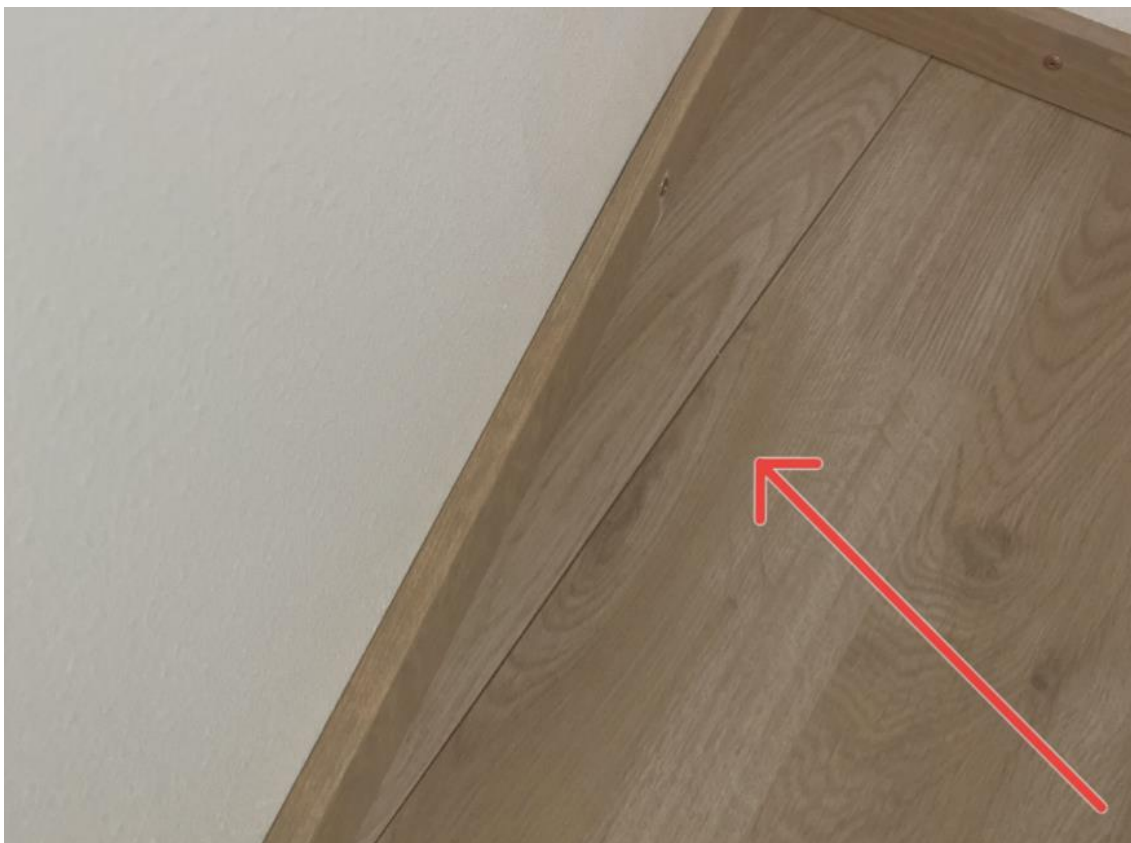
Kuva 5 Virheellisesti asennettu laminaatti (Jatke Uusimaa Oy, 2024)
