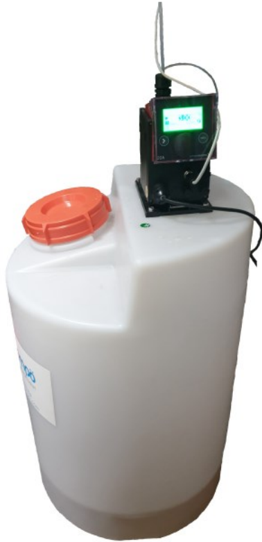
Kuva 10. Kemikaaliannosteluasema (KL-lämpö Oy n.d.)
