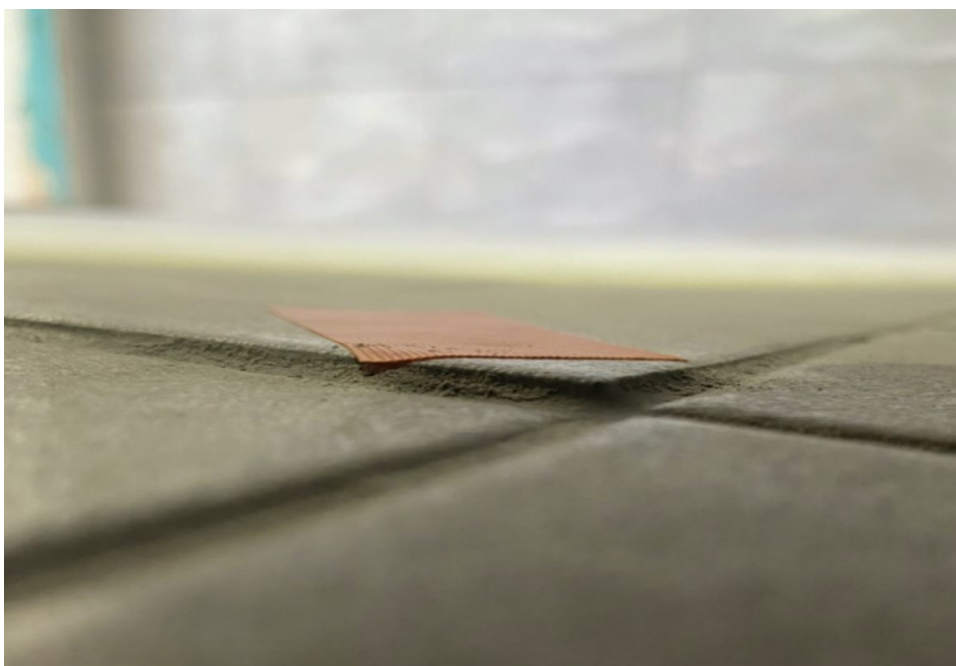
Kuva 4. Lattialaatoituksessa huomattu laatuvirhe.
