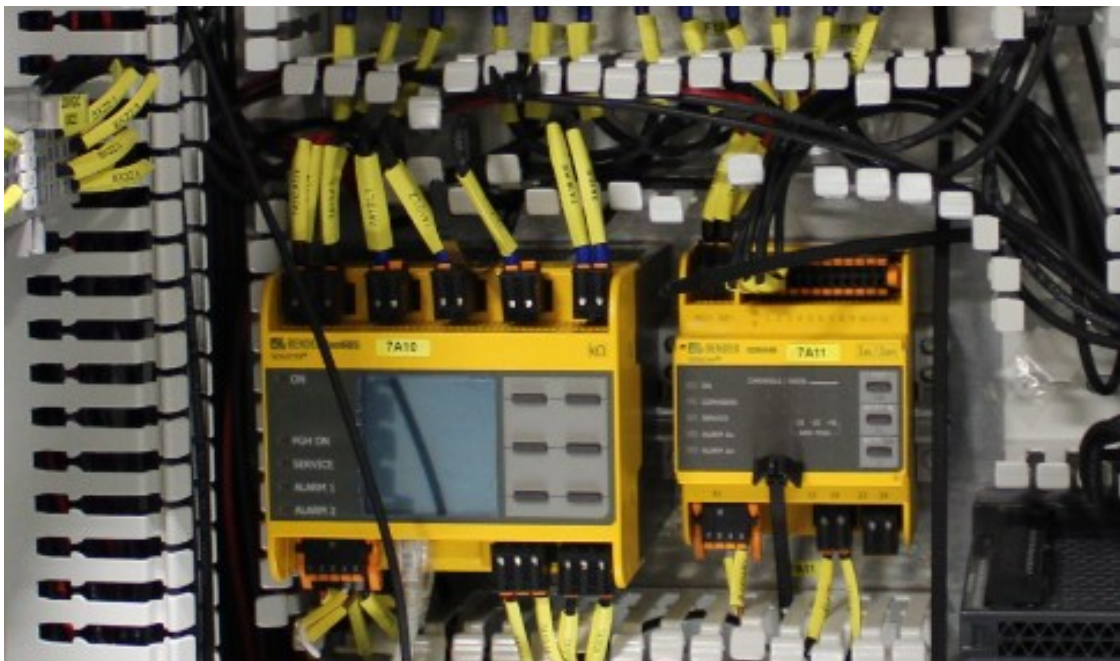
Kuva 10: Iso685 ja EDS asennettuna esimerkkiprojektin sähkökeskukseen.
