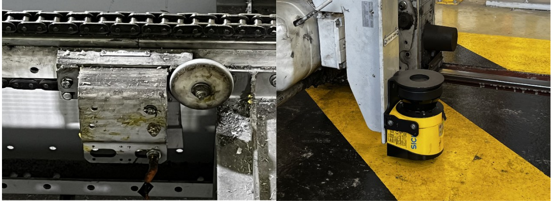
Kuva 11. Vasemmalla rajakytkin ja oikealla SICK-turvalaserskanneri
