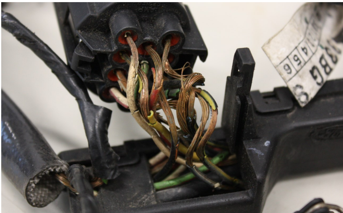
Kuva 2. Alkuperäisen johtosarjan vaurioita.
