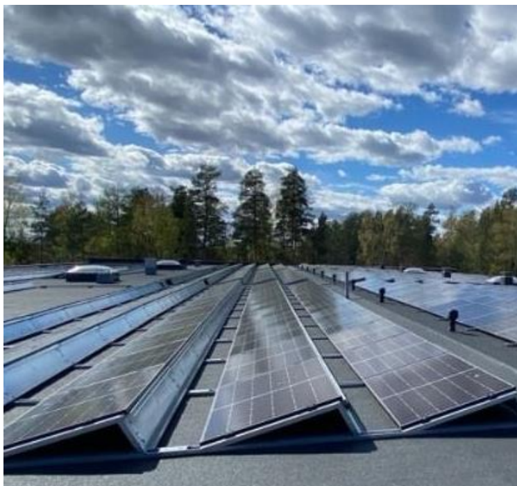
Kuva 13. Aurinkopaneelikenttä tasakatolla kulmaan asennettuna (Orima-Tuote, n.d.)
