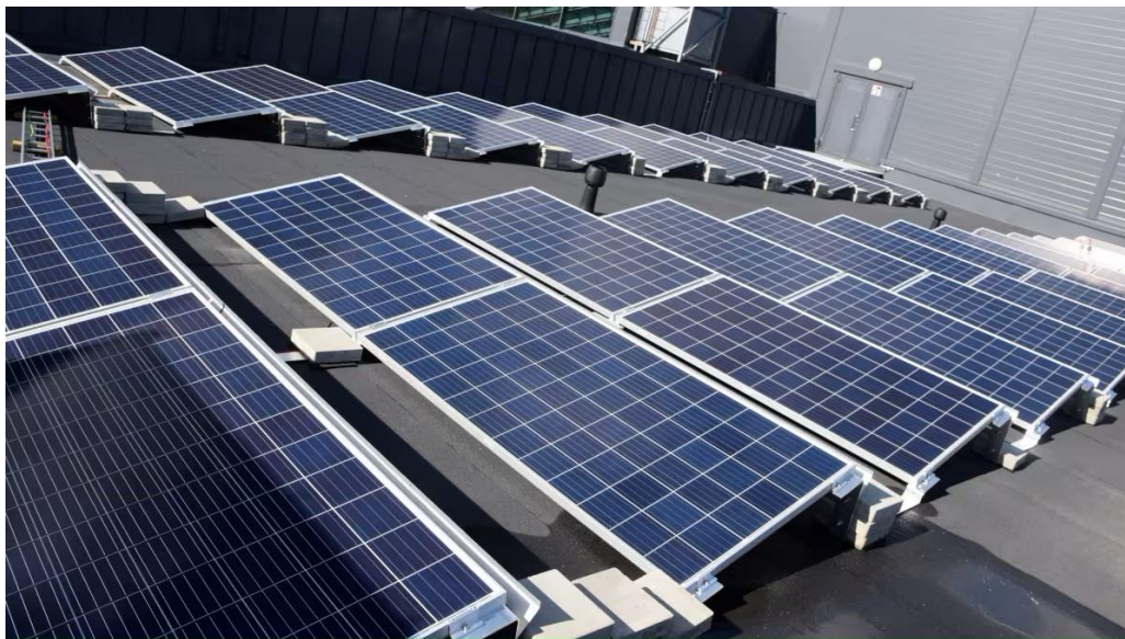
Kuva 5. Kelluva aurinkopaneelijärjestelmä betonisilla vastapainoilla (Rautavuori 2018.)
