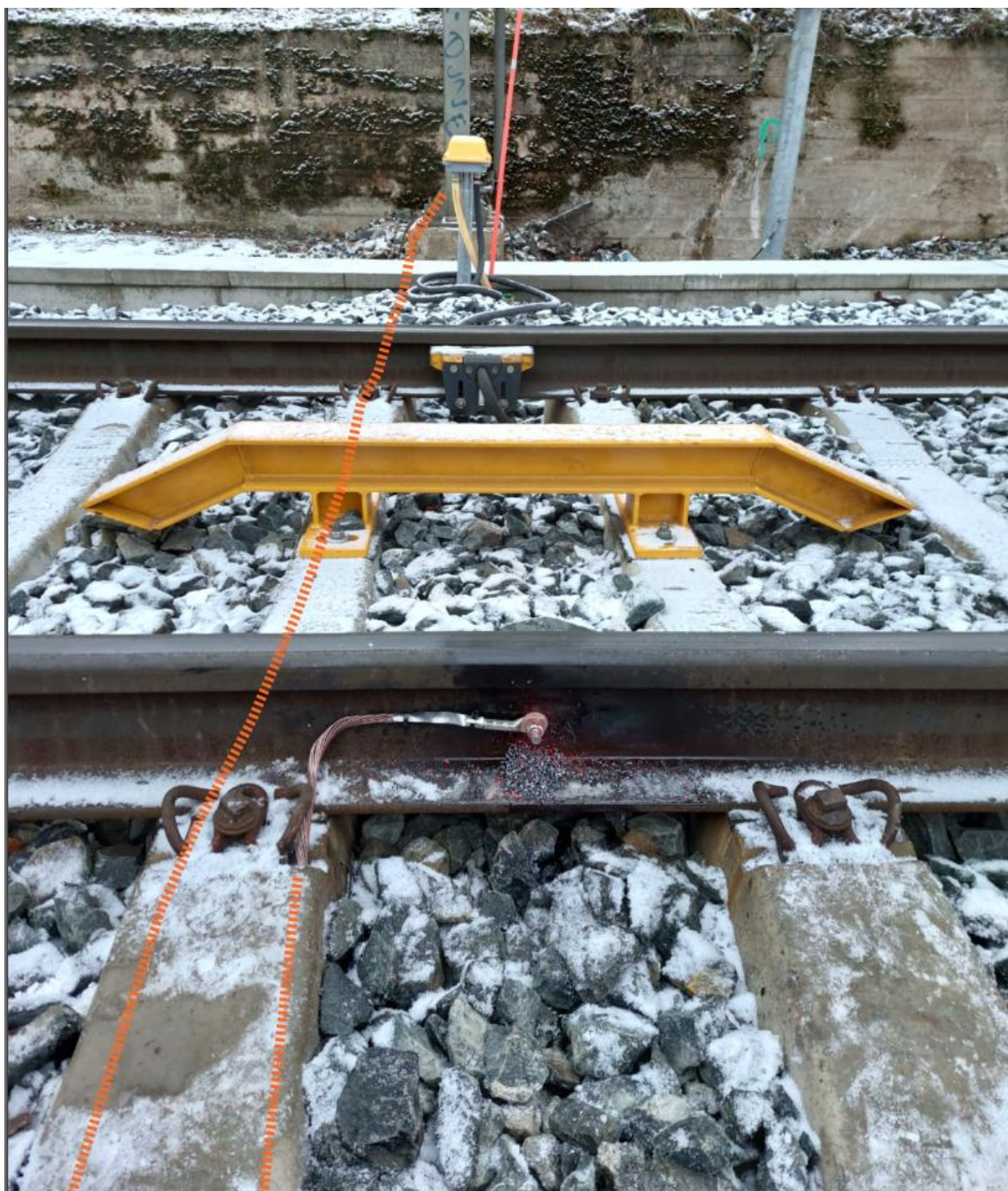
Kuva 29. Pylvään suojamaadoitus paluukiskoon (Kuronen 2024, CC BY-NC-SA)
