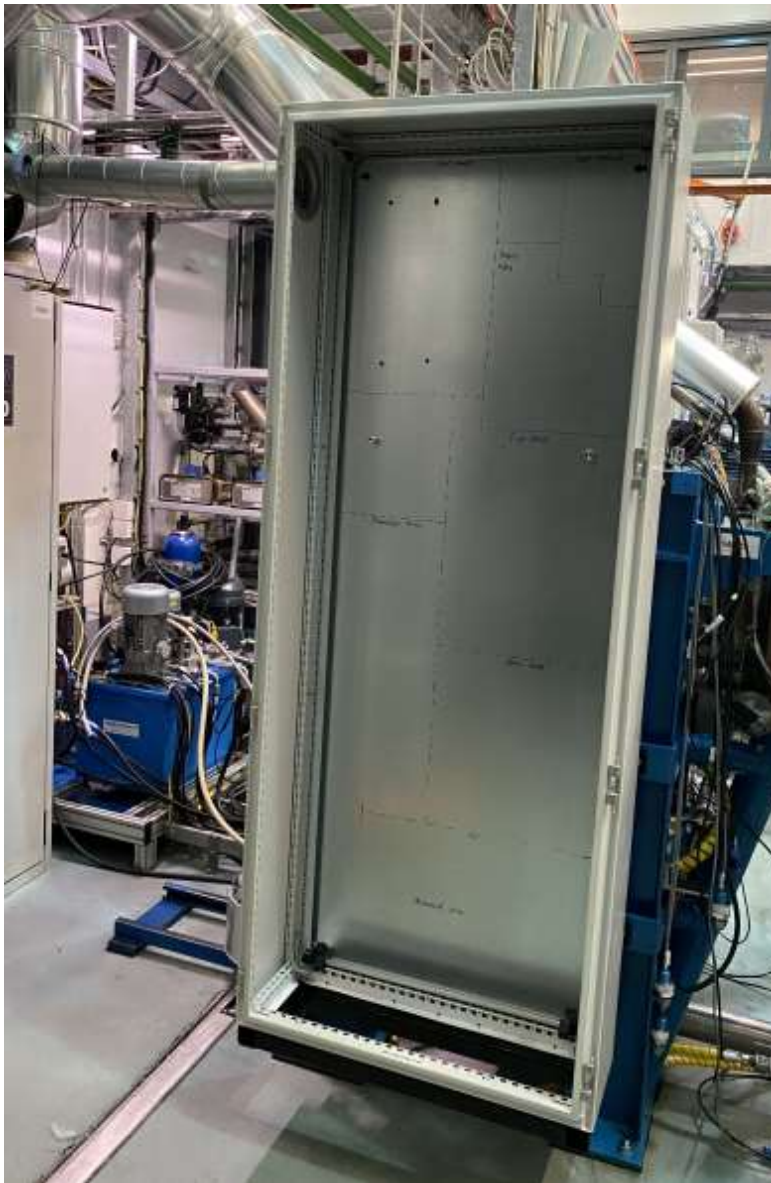
Figur 23: Provmontering av skåpet i test cellen.
