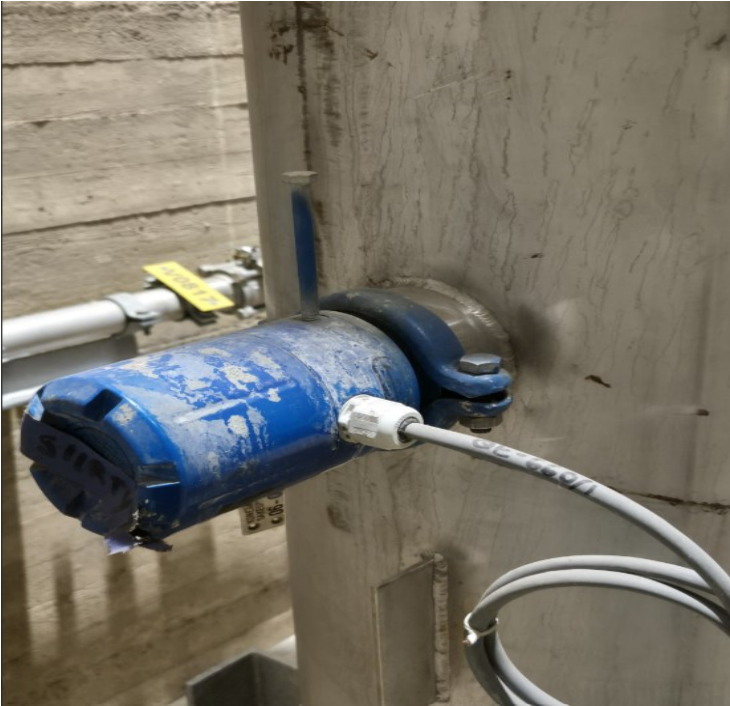
KUVA 6. LAPA-lähetin asennuspaikassaan pystyputkessa.
