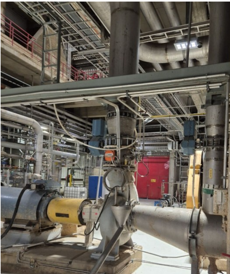
KUVA 5. MCA:n asennuspaikka ja toimilaite.
