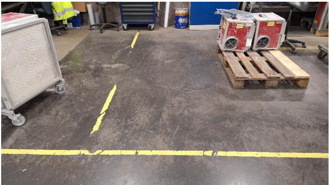
Kuva 12. Teippaukset lattiassa ovat kuluneet.
