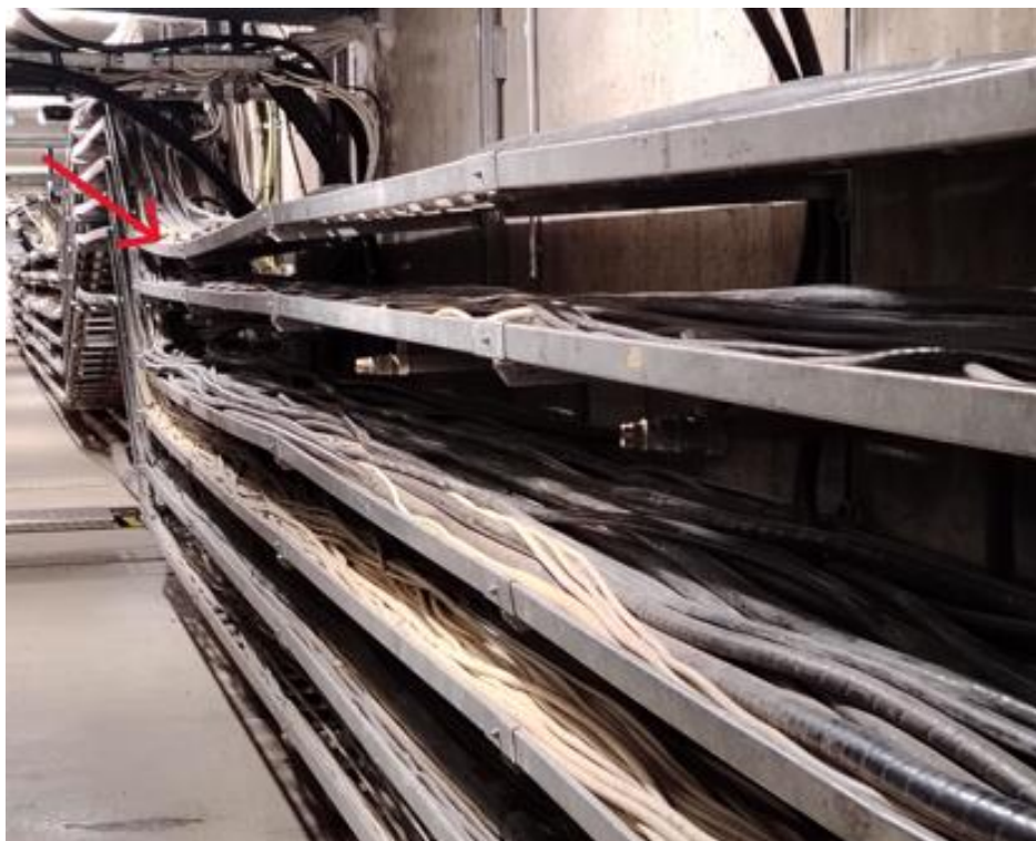
Kuva 7. Notkolleen romahtanut kaapelihylly kaapelitunnelissa (nuoli) sekä yli täysiä kaapelihyllyjä
