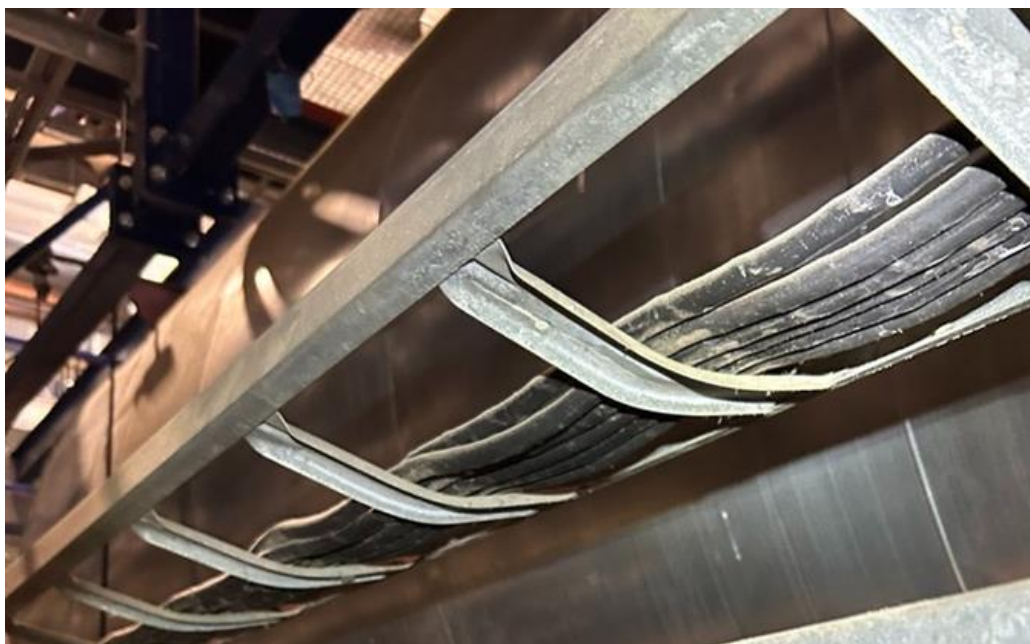
Kuva 8. Vääntynyt kaapelihylly turbiinihallissa
