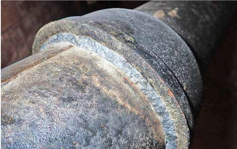
Kuva 10. Lyijyliitos valurautaviemärissä /14, s. 19/
