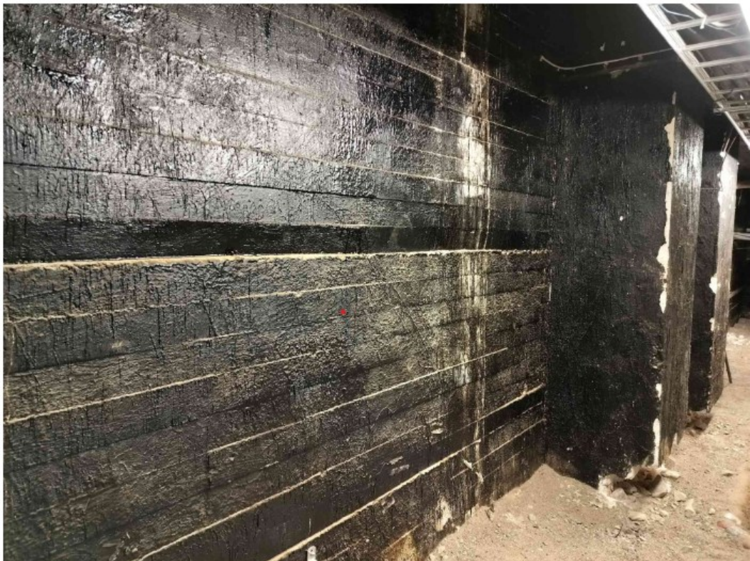
Kuva 6. Kreosotilla pinnoitettu kellarin seinä /8/
