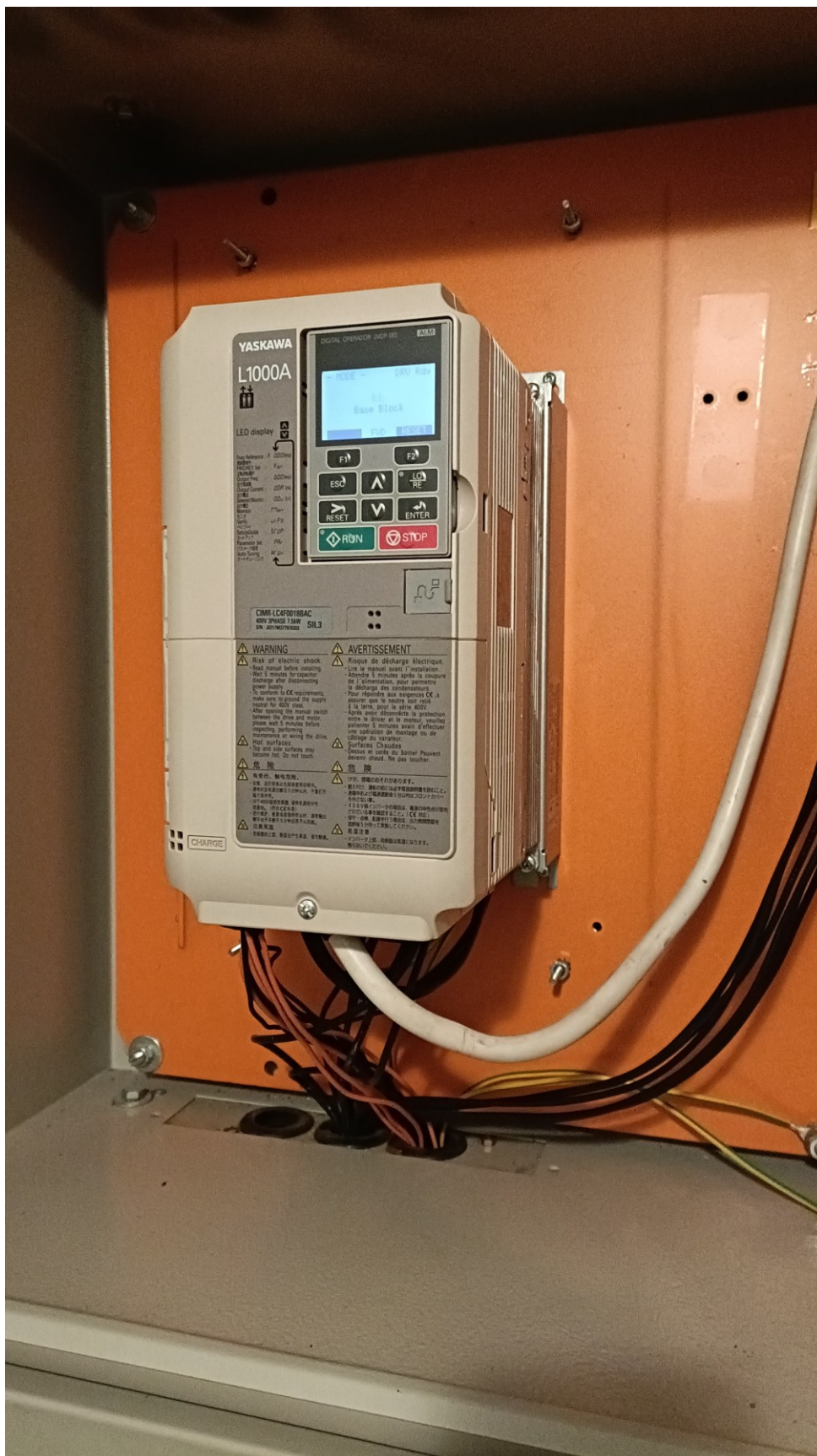
Kuva 20. Yaskawa L1000A asennettuna Ascentronic Type A:n tilalle.
