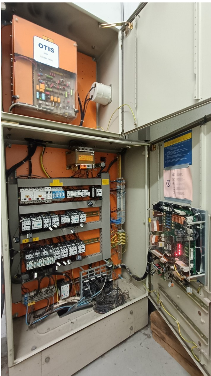
Kuva 18. Otis MCS 310 -ohjauskeskus.
