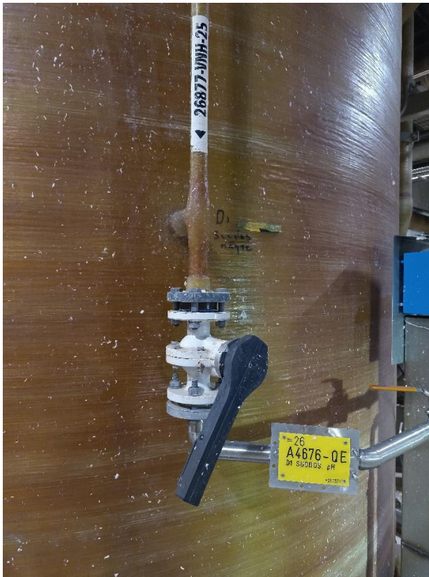
Kuva 5. D1-linjan korvattava käsiventtiili.
