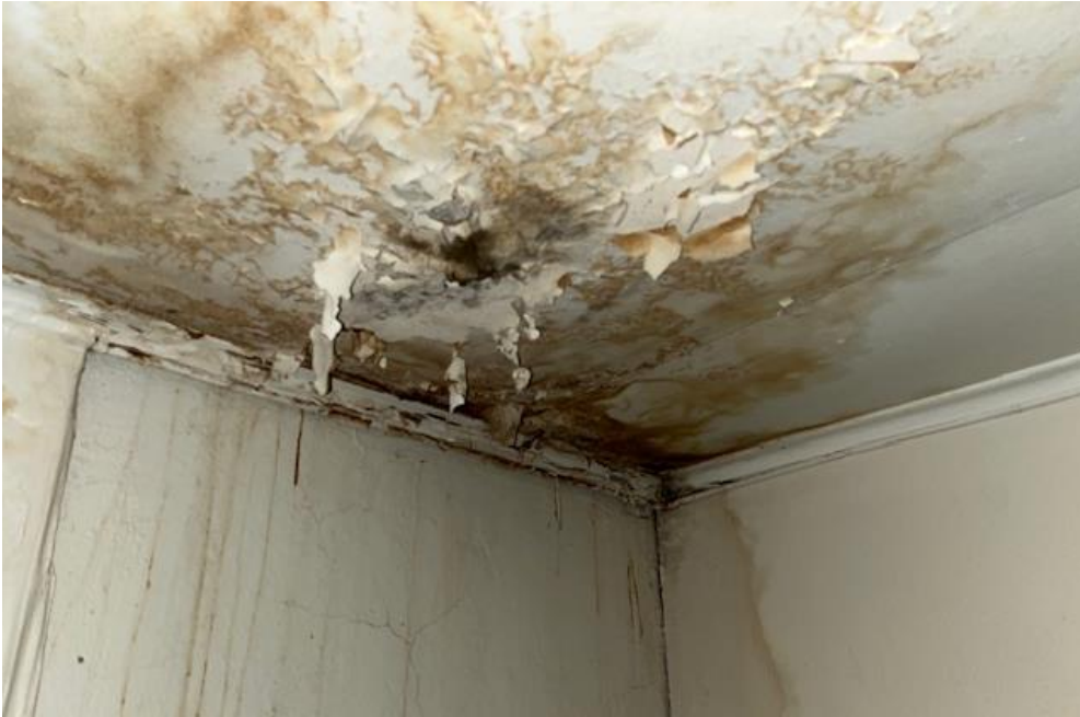
KUVA 13. Hormin vuodon aiheuttama kosteusvaurio toisessa kerroksessa
