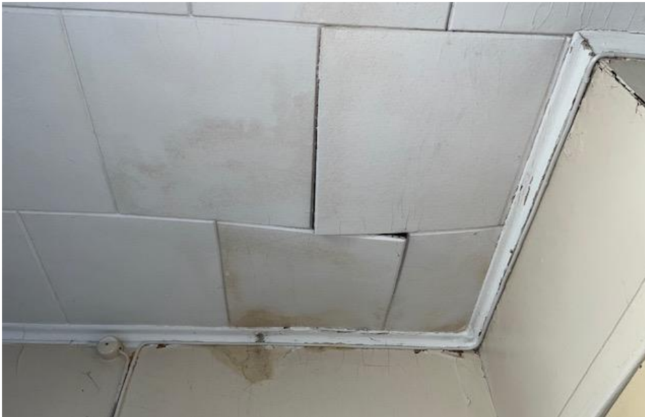
KUVA 12. Hormin vuodon aiheuttama kosteusvaurio ensimmäisessä kerroksessa
