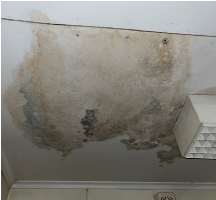
KUVA 15. Kosteusvaurio eteisen katossa
