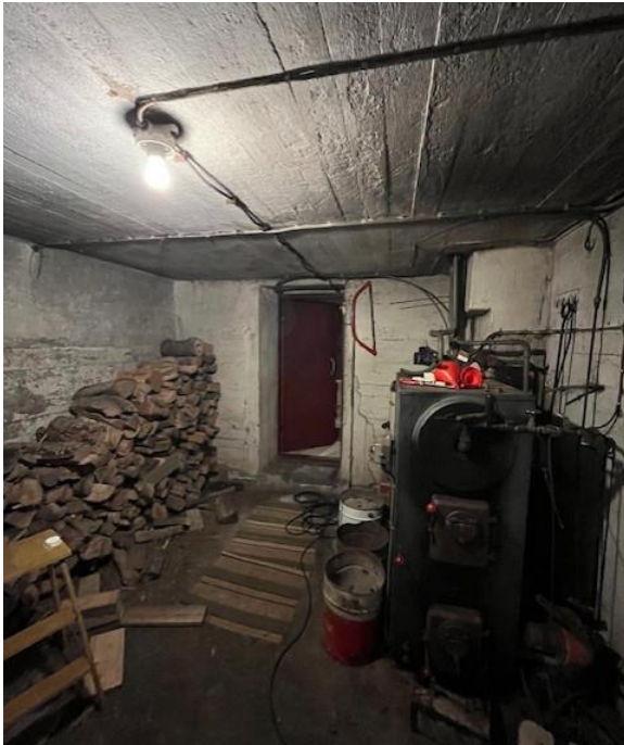
KUVA 27. Kellarin puuvarasto ja lämpökattila
