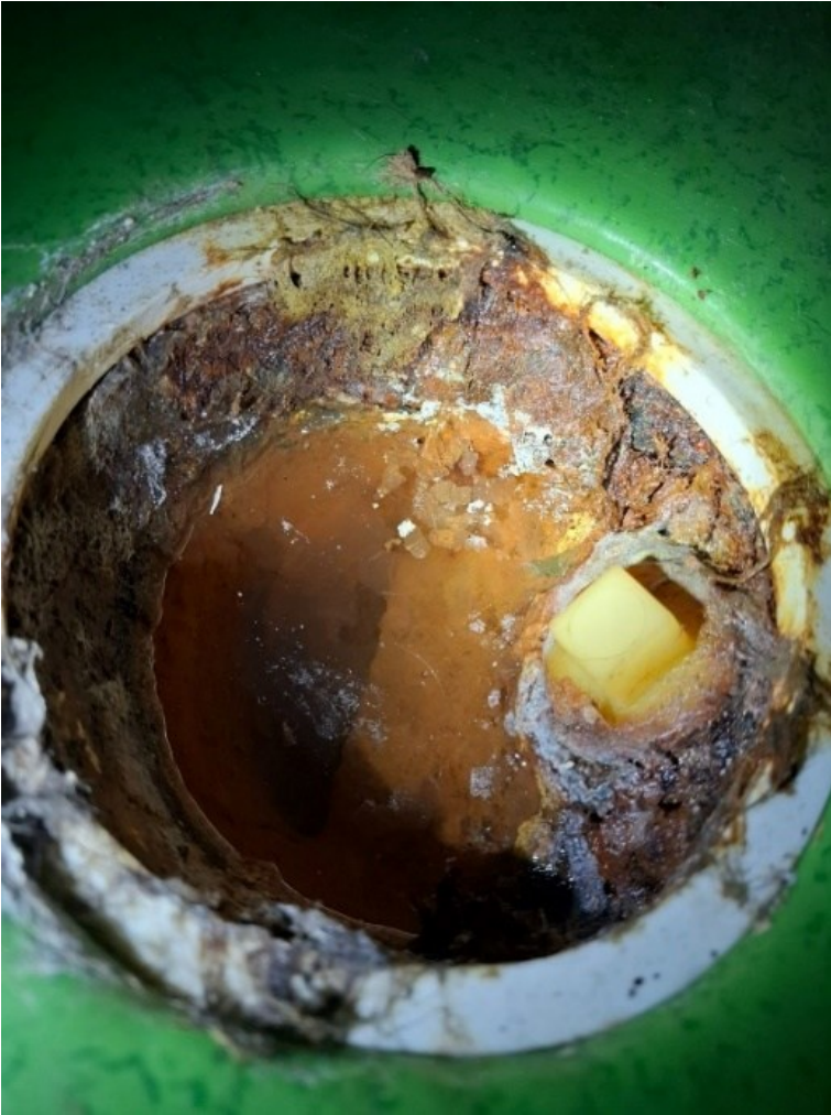
Kuva 9. Ruostunut ja mahdollisesti epätiivis lattiakaivo. Muovimattopinnoitteen käyttöikä on ohitettu.
