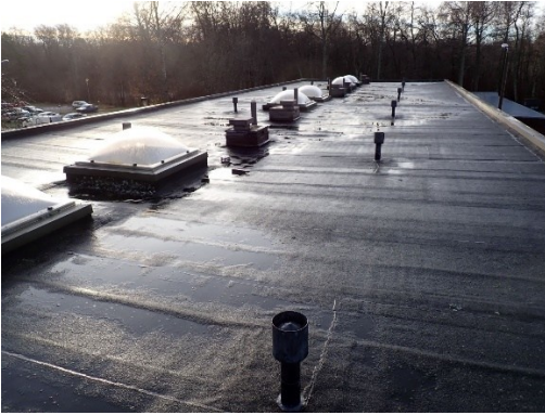
Kuva 2. Vesikatteille lammikoituu vettä.
