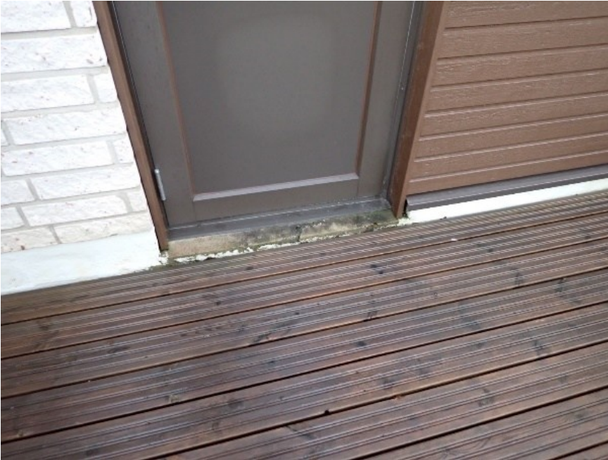
Kuva 7. Ulko-ovien kynnyspellit loppuvat ennen kivijalan ulkoreunaa.
