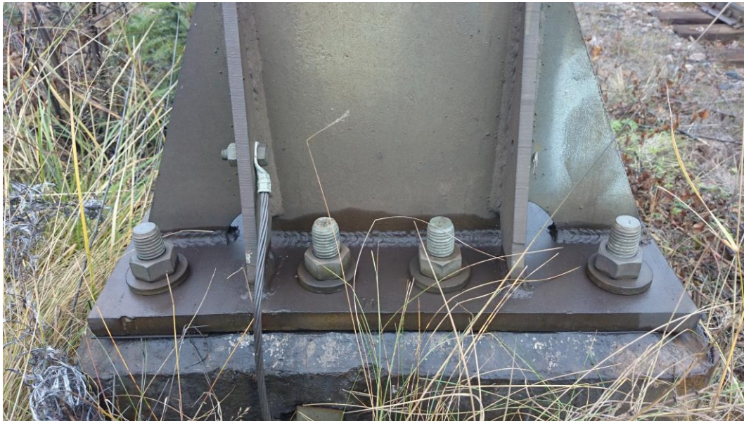
KUVIO 3. Metallisen ratajohtopylvään maadoituslähtö
