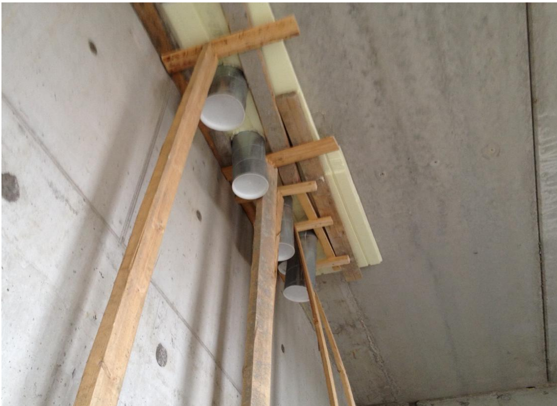
KUVA 23. Jälkivalettavien läpivientien osalta jää työvaiheita pois, kun esimerkiksi valmiit IV-kanavan osat upotetaan jo varsinaiseen valuun
