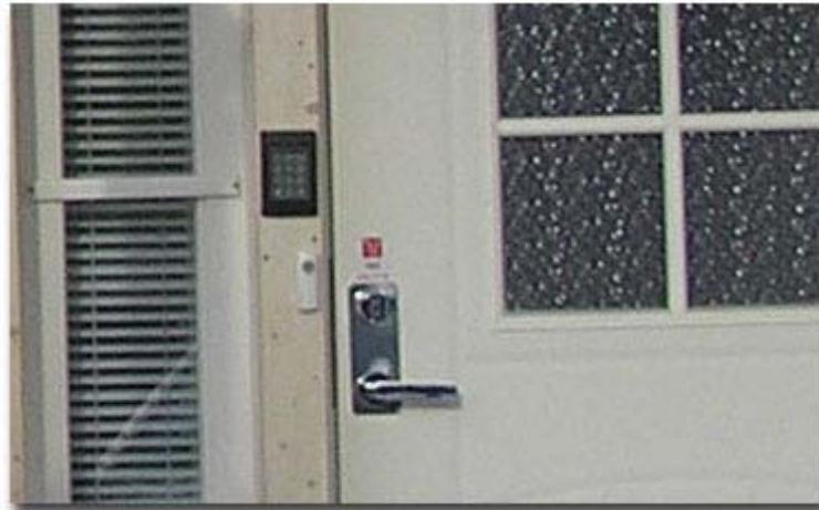
Kuva 1 Koodi ja kortinlukijalla varustettu ohjauspaneeli lukolle./11/
