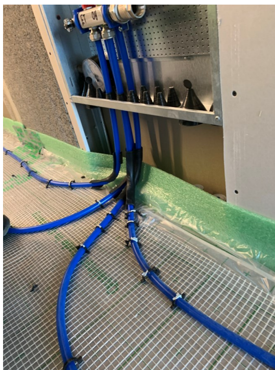
Kuva 25. Väliseinän sisään sijoitettu jakotukkikaappi, kuva työmaalta A, 2022.
