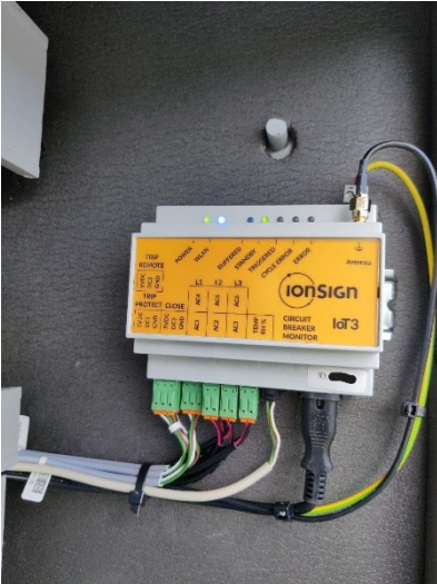
Kuva 7. IoT3-päätelaite katkaisijalle ja virtamuuntajalle
