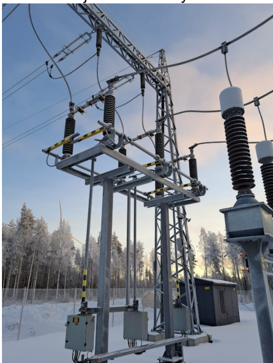
Kuva 3. 110 kV:n kiertoerotin ja maadoituskytkin
