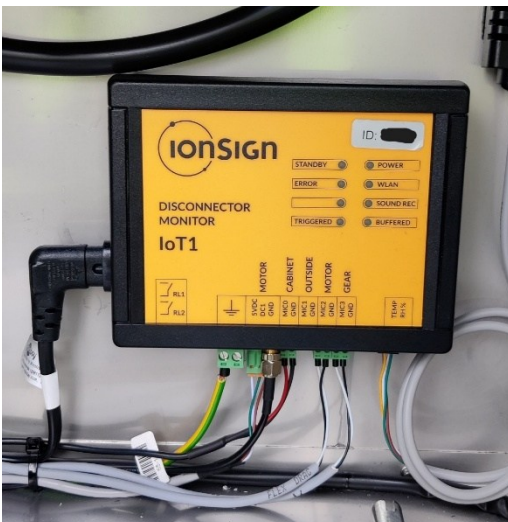
Kuva 5. IoT1-päätelaite erottimen ohjainkotelossa
