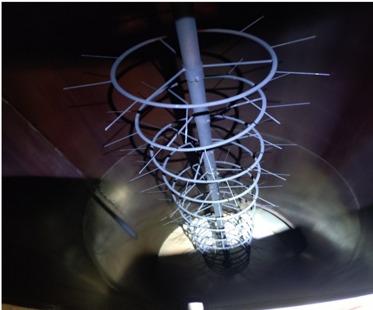
Kuva 9. Ion Blast- sähkösuodatin sisältä (Komulainen 2025d)
