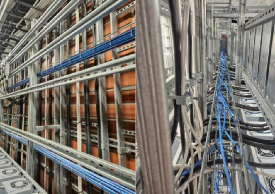
KUVA 8. Profinet-kaapelointia, jossa on huomioitu 90-asteinen risteytyminen ja välimatkat.
