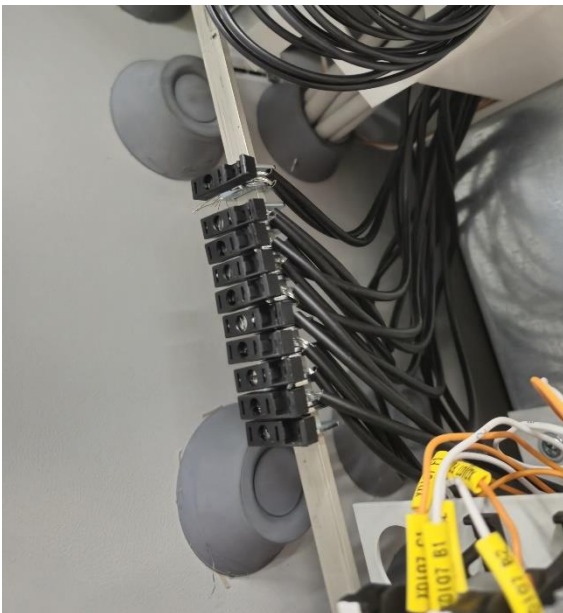
KUVA 4. NOMAK-kaapeleiden suojajohtimet IO-kaapin FE-kiskossa.
