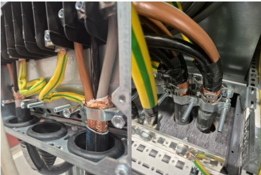
KUVA 5. MCCMK-kaapeleiden 360-asteinen maadoitus seinään kiinnitettävässä ja kaappimallisessa taajuusmuuttajassa.
