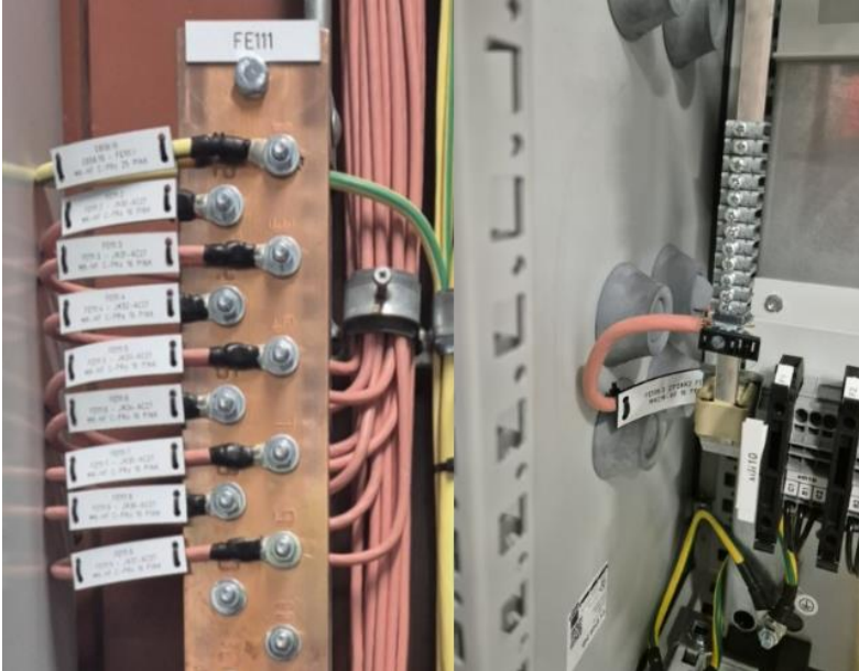
KUVA 3. Sähkötilan FE-kisko ja FE-johtimen yhdistys IO-kaapin kiskoon.
