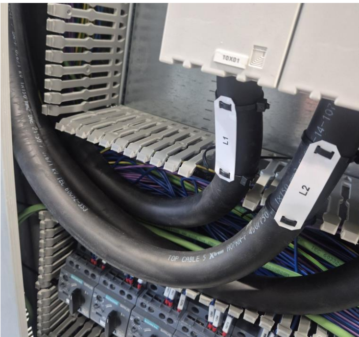
KUVA 12. Toinen esimerkki keskuksen huonosta johdotuksesta.
