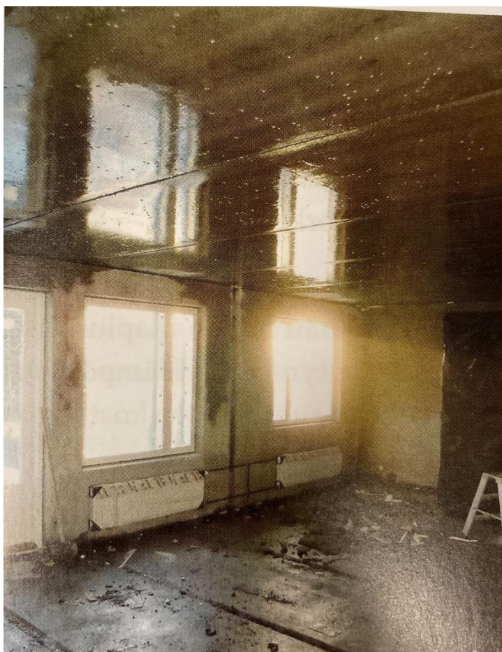
Kuva 3. Yläpohjaan syntynyt kastepiste. (Teriö & Hämäläinen 2017, 7.)
