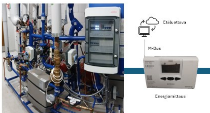
Kuva 12. Erään rakennuksen kaukolämpövaihdin ja energiamittaus esitettynä.
