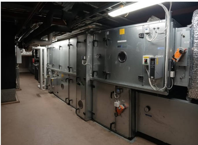
Kuva 13. Erään rakennuksen koteloitu ilmavaihtokone.
