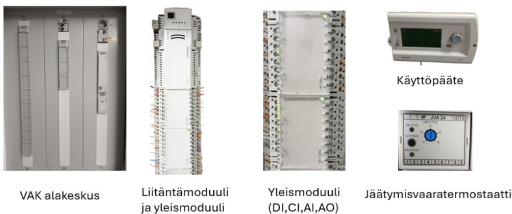
Kuva 41. Erään rakennuksen valvonta-alakeskus ja keskuksessa olevia komponentteja.
