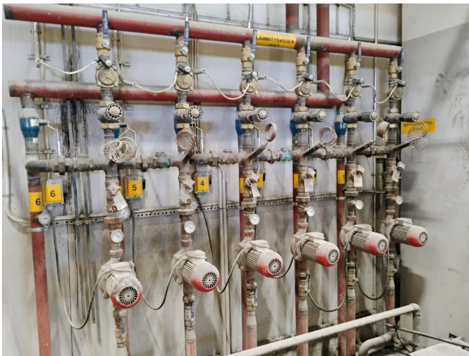
Kuva 12. Lämmitysjärjestelmän kiertovesipumppuja ja venttiilejä.
