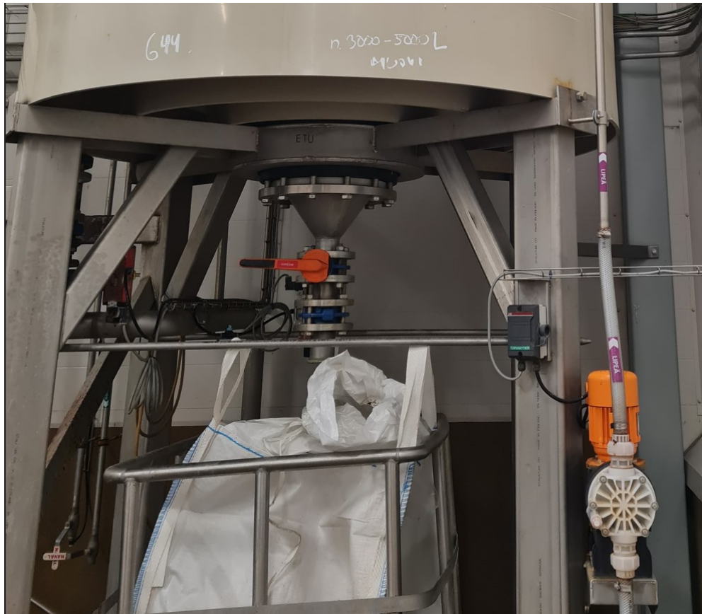
Kuva 5. Lipeän annostelupumppu, säiliön pohjaventtiili ja suodatuspussi.
