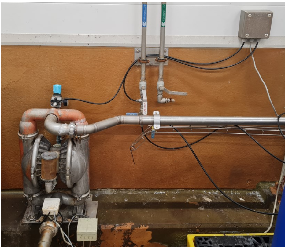
Kuva 8. Vanhan laitteiston kalvopumppu ja yksi pintaraja.
