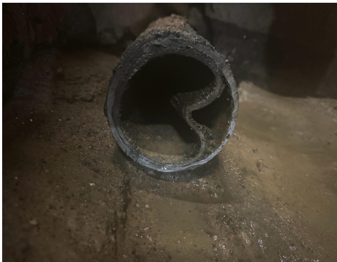
Kuva 13. Epäonnistunut viemärin sukitus.
