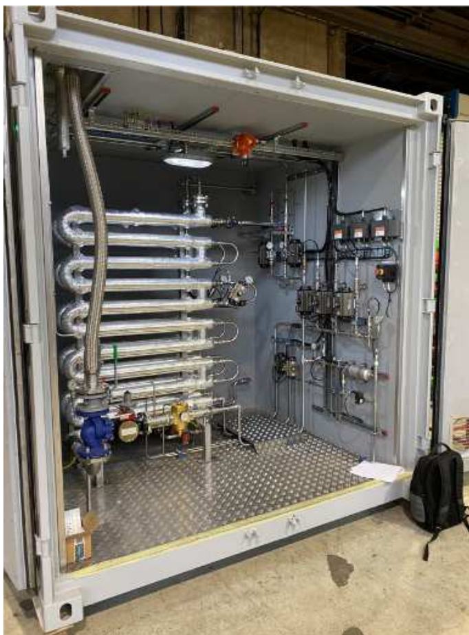
KUVA 14. Paineenalennusyksikkö (Biovoima Oy 2019b).
