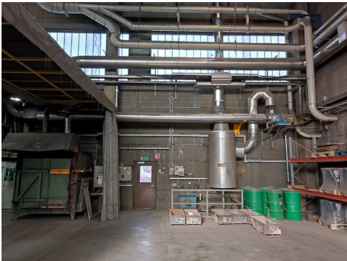
KUVA 1. Polttokaappi, poltin ja oheislaitteet (Nissinen 2023).
