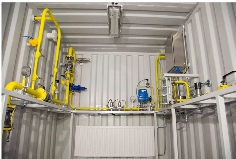
KUVA 13. Paineenalennusyksikkö (Biovoima Oy 2019b).
