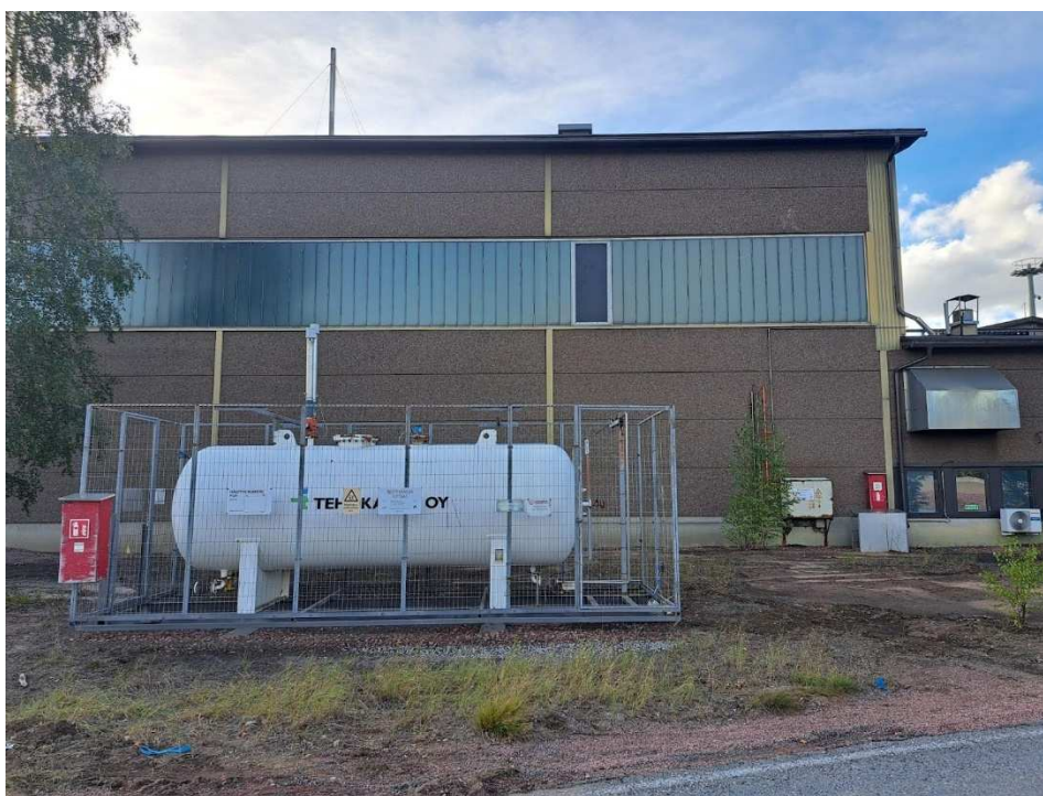
KUVA 5. Polttoainesäiliö ja säiliön oikealla puolella rakennuksen seinustalla oleva nestekaasuhöyrystin (Malmi 2024).
