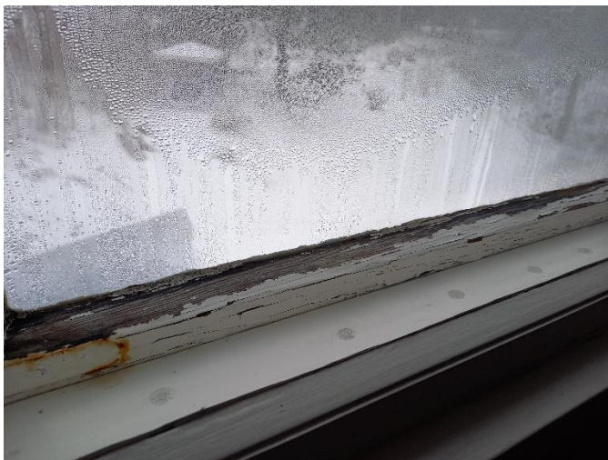
Kuva 53 Idänpuoleisen päädyn ikkuna, havaittavissa kosteutta ja maalipinnan irtoilua
