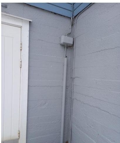
Kuva 19 Sähköt kaapelia pitkin taloon vuonna 1998
