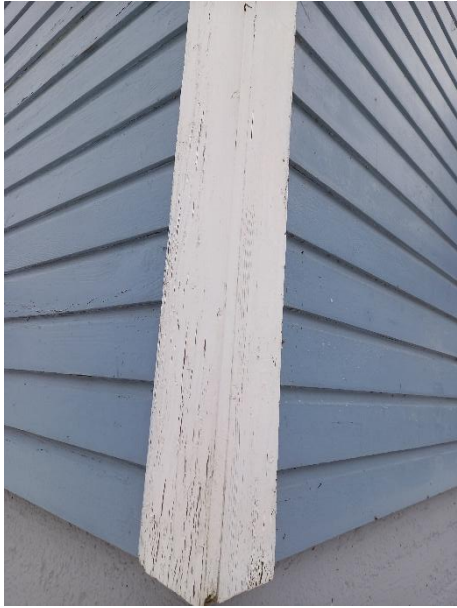
Kuva 42 Eteläpuoleisensivun kulma, maali irronnut
