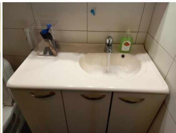
Kuva 58 Vedenpaine on hyvä
