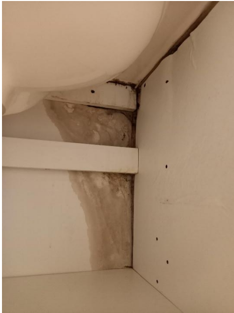
Kuva 63 Wc altaan alla valumajälkiä
