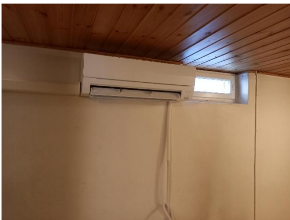
Kuva 8 Alakerran ilmalämpöpumpun sisäyksikkö
