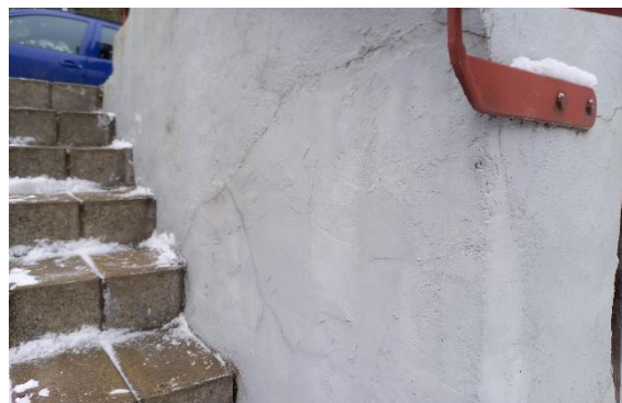
Kuva 48 Kuistin betoni pintaa
