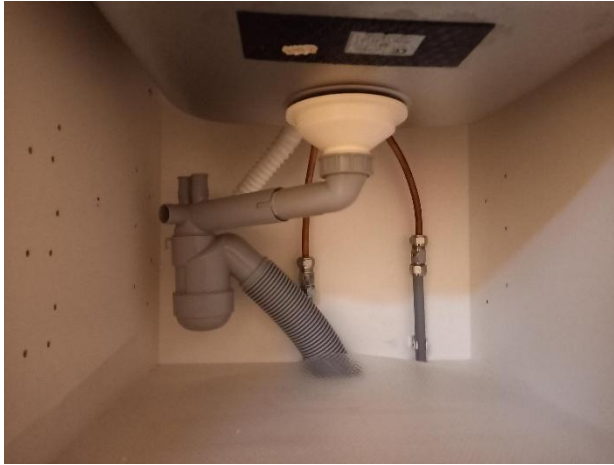
Kuva 12 Alakerran vesipisteen putkiliitokset
