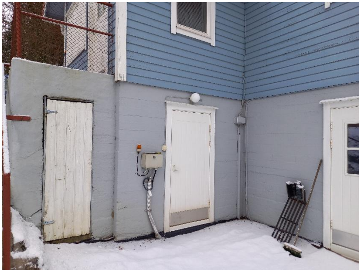
Kuva 38 Maalipinnan irtoilua havaittavissa
