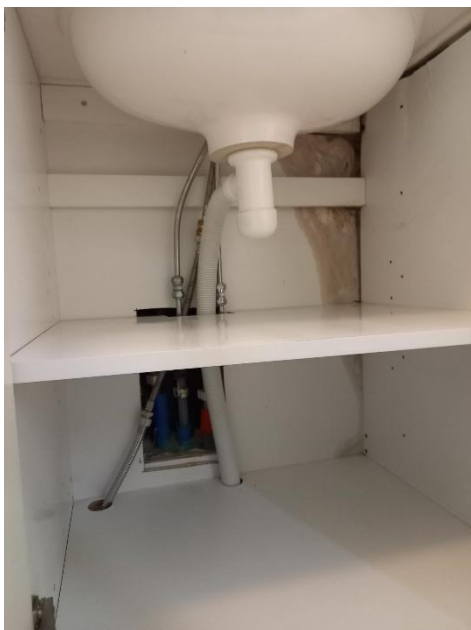
Kuva 64 Wc altaan alla valumajälkiä
