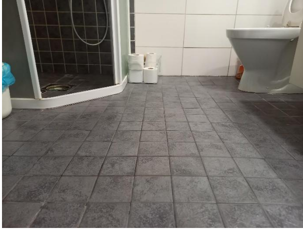
Kuva 60 Wc lattian kaadot tehty huonosti
