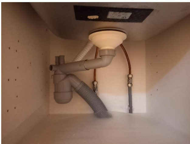
Kuva 71 Alakerran vesipisteen liitokset
