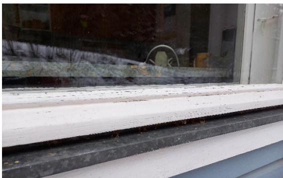
Kuva 44 Ikkunoissa havaittavissa maalin irtoilua
