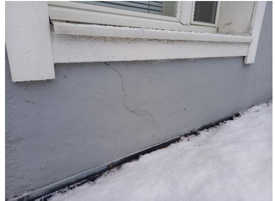
Kuva 52 Eteläsivu, Havaittavissa halkeamia sokkelissa
