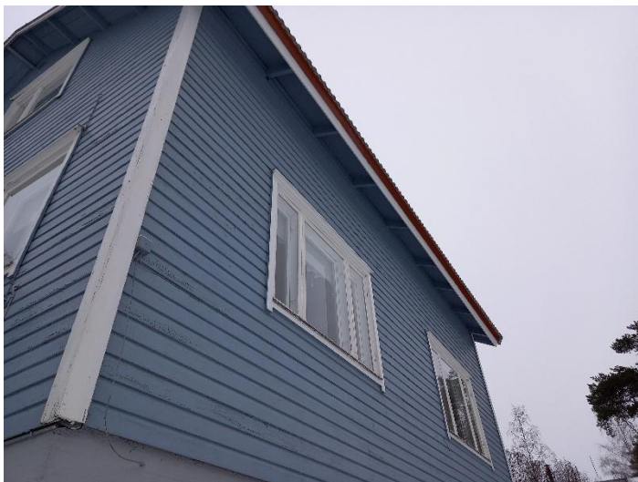
Kuva 40 Eteläpuoleinen julkisivu, havaittavissa maalin irtoilua
