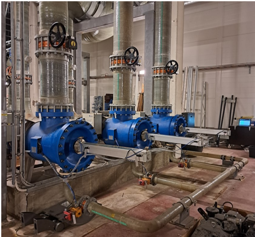
Kuva 6. Prosessissa olevat Bernoulli-suodattimet.
