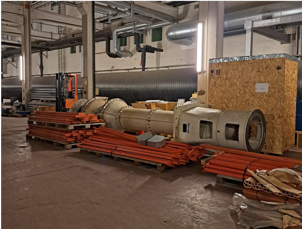
Kuva 5. Prosessista poistettu Sulzer-merivesipumppu.
