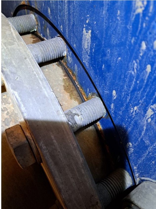
Kuva 12. Lämmönsiirtimen laippatiivisteiden ympärillä oleva korroosio.
