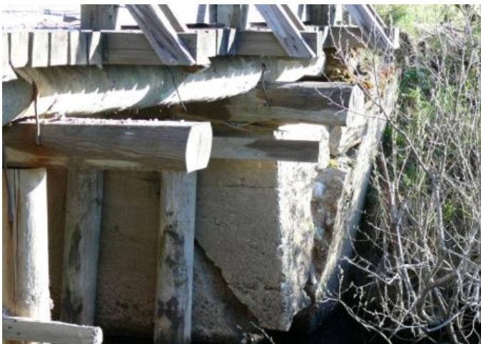
Kuva 4. Betonisen perustuksen halkeama (Heikkinen 2023)
