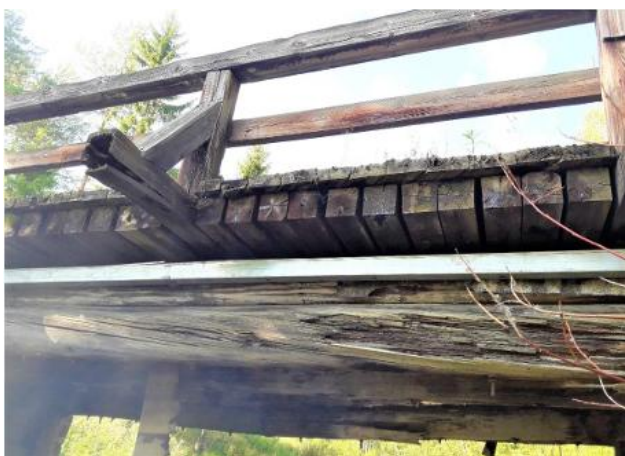
Kuva 3. Lahovaurioitunut puusilta (Heikkinen 2023)
