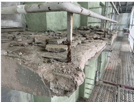
Kuva 20. Parvekkeessa pitkälle edenneet vauriot paljastuvat usein korjatessa. (Kotopro, PRM-Yhtiöt Oy, 2024)
