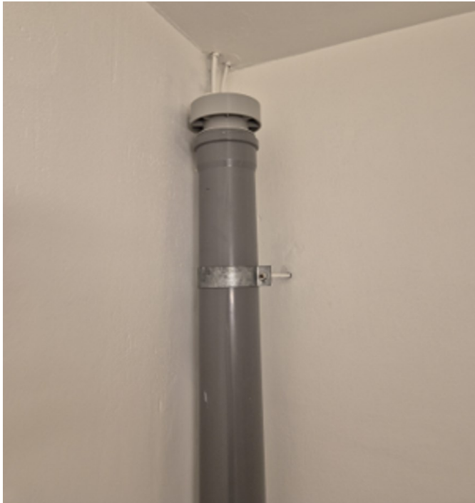
Kuva 11. Viemärin tuuletusventtiili väestönsuojassa.
